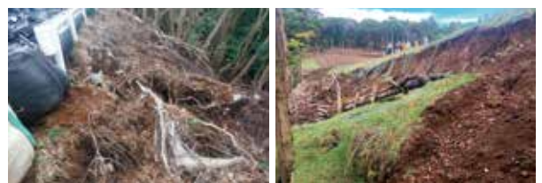
崩れかかった斜面と放置された伐採木
